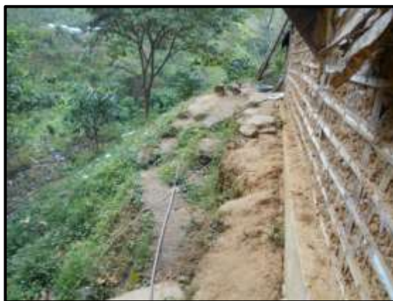
Talud inestable pendiente media
