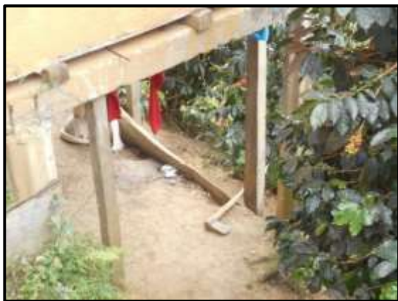
Vivienda en ladera inestable
